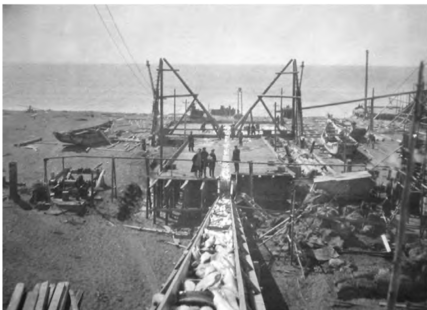
Пристань и элеватор на новом заводе фирмы «Тайхоку Гио-Гио Кабусики Кайша» на месте разрушенных цунами
